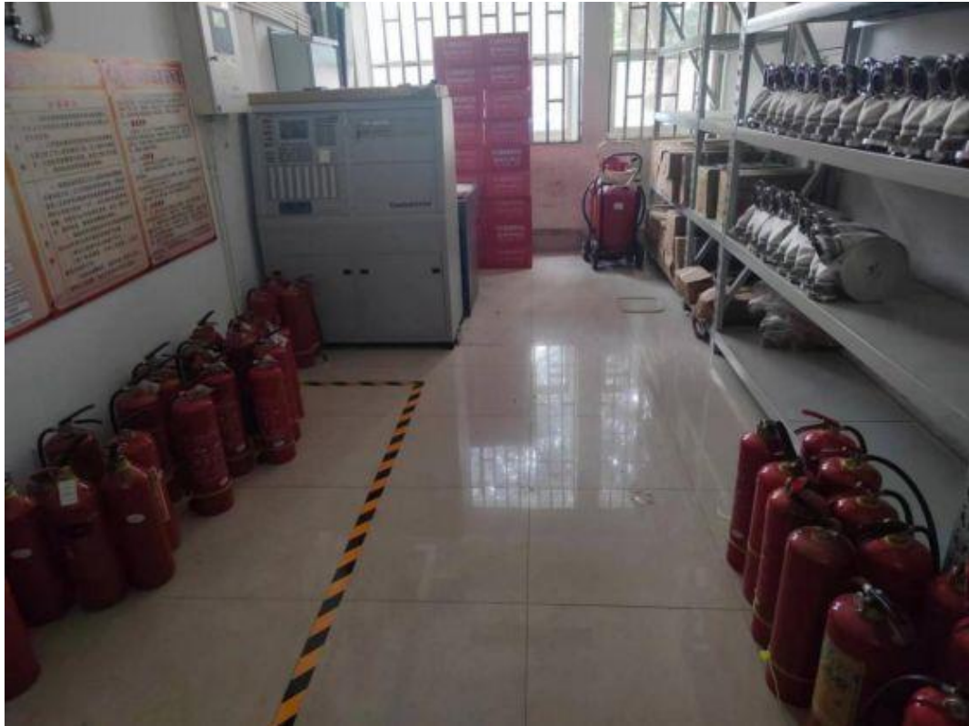
图 56 校园安全之消防设备
