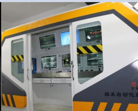
图3-35 教学矿井智能化采煤系统顺槽集控中心
