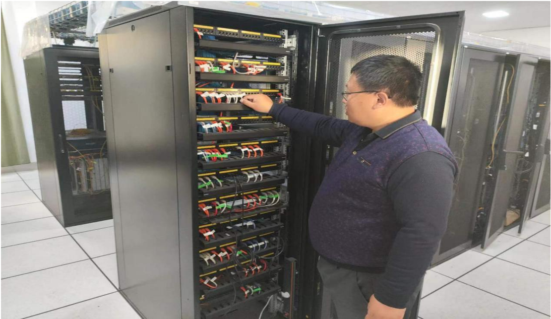
图 48 定期检查，保障网络安全运行
