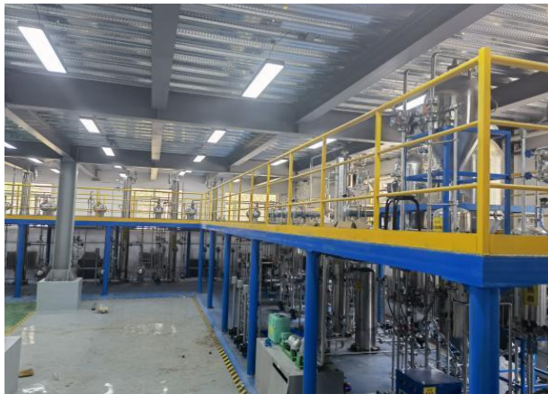
图 6-6 催化裂化仿真工厂装置
