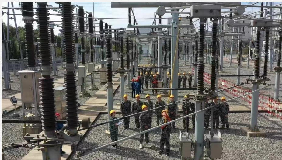
图 6-8 学院产教融合实践中心 220KV 实训变电站开展企业员工培训
