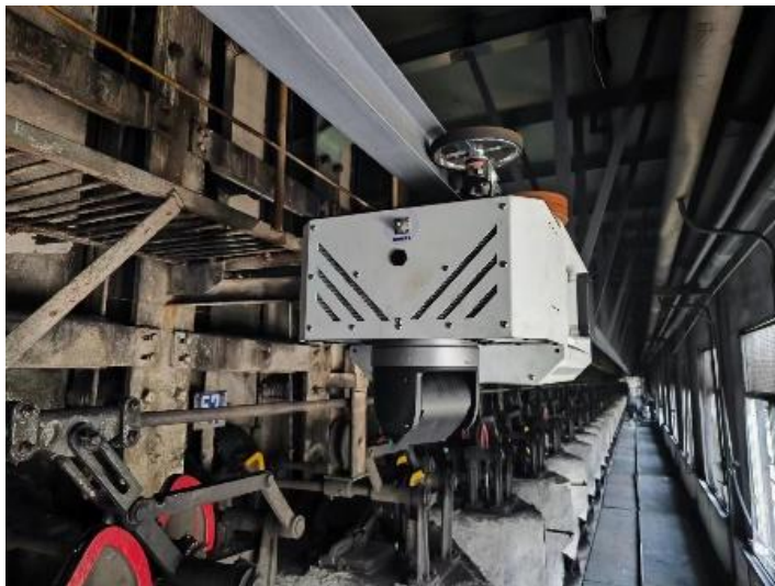
图54 研制的安全应急巡检机器人在宁波钢铁焦炉巡检
