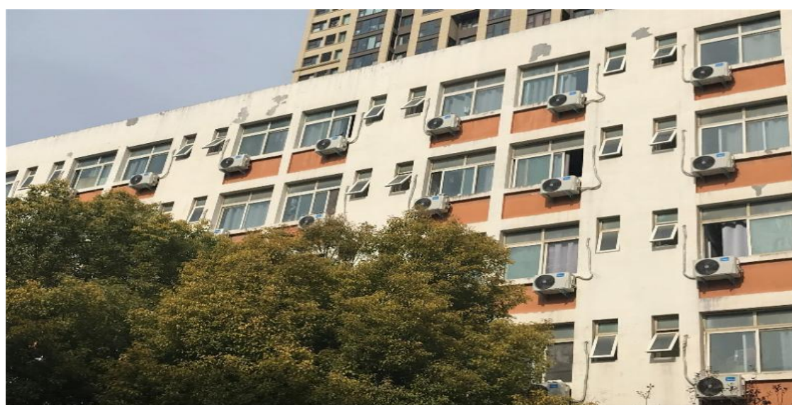
图 68.学生宿舍空调安装
