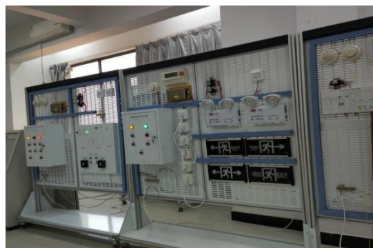
图 3-6：校企共建消防实训室
