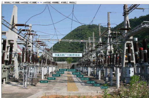
图 49：湖北黄龙滩水电厂变电站现场实景模拟
