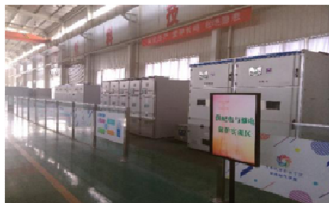
图 3-3 继电保护及配用电实训基地
