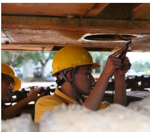
图 6 2018 年广西交通运输行业职业技能比赛筑路工赛项的我院选手在进行挖掘机故障测量
