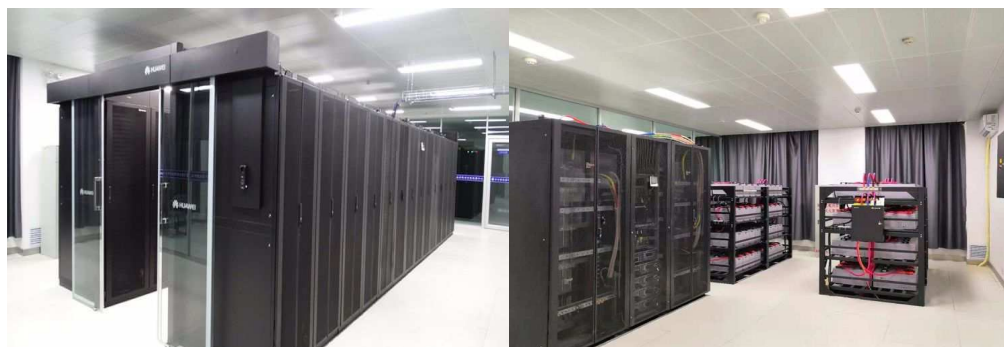
云计算数据中心—机房
