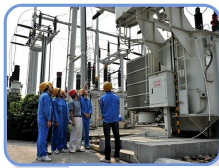
学生在变电站实训
