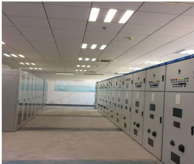
图 3-2 高铁牵引变电所实训室
