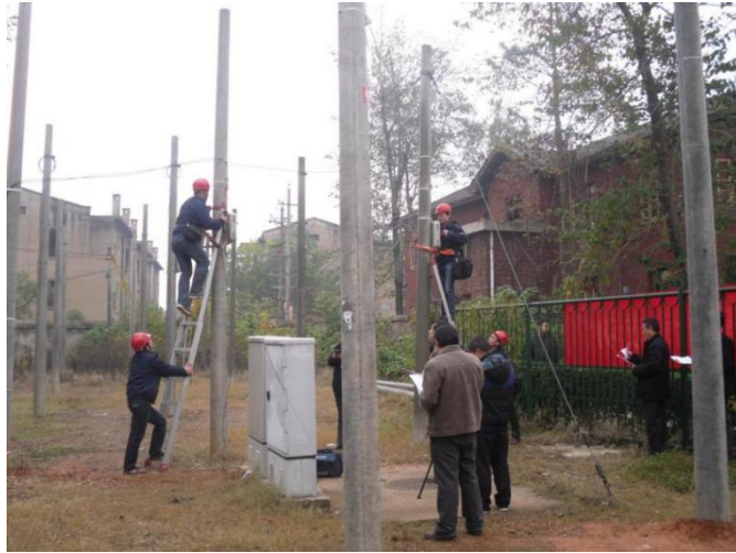
图 22 通信光缆实训基地
