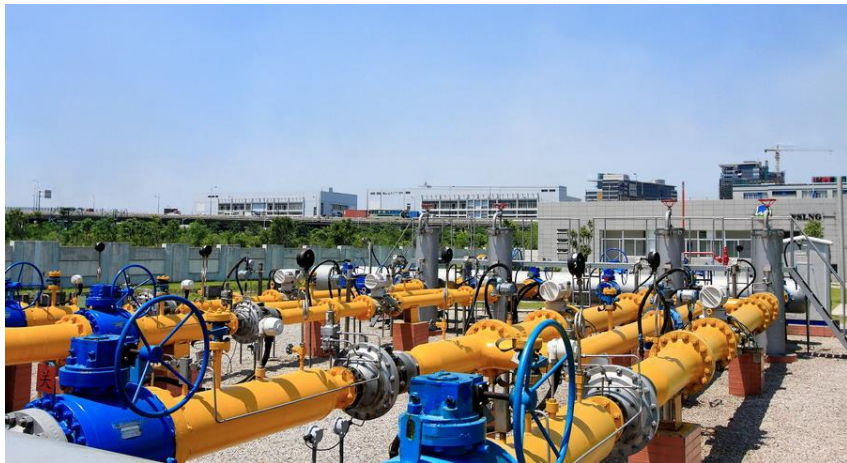
图 4 瀚蓝环境股份有限公司燃气供应站
