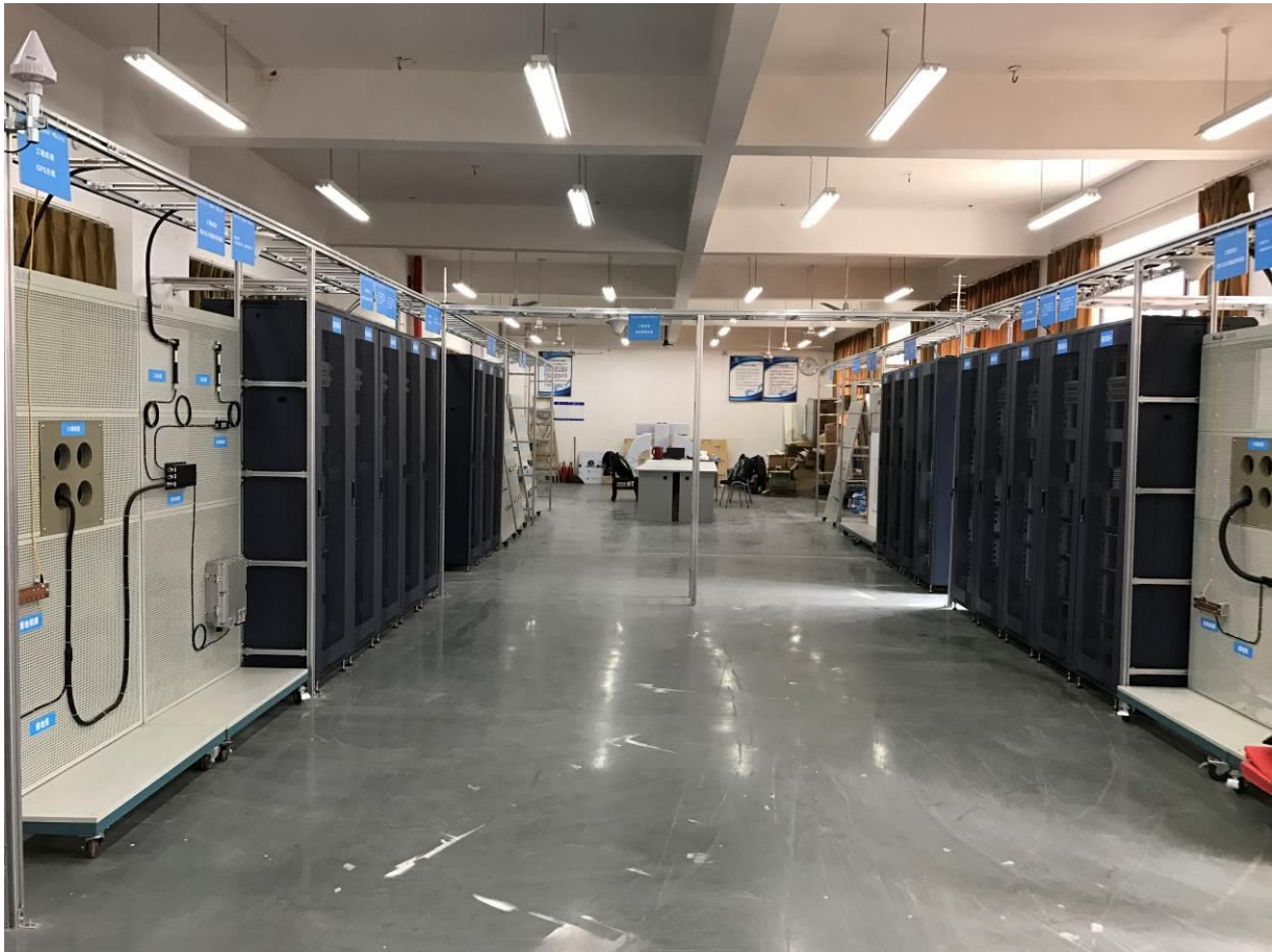
图 7 教育部—中兴通讯 ICT 行业创新基地实训室（电信工程实训室）
