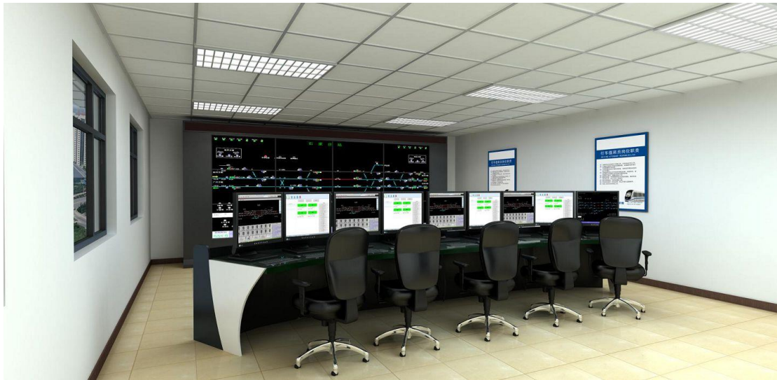
图 3-22 完成的管理控制系统投入使用
