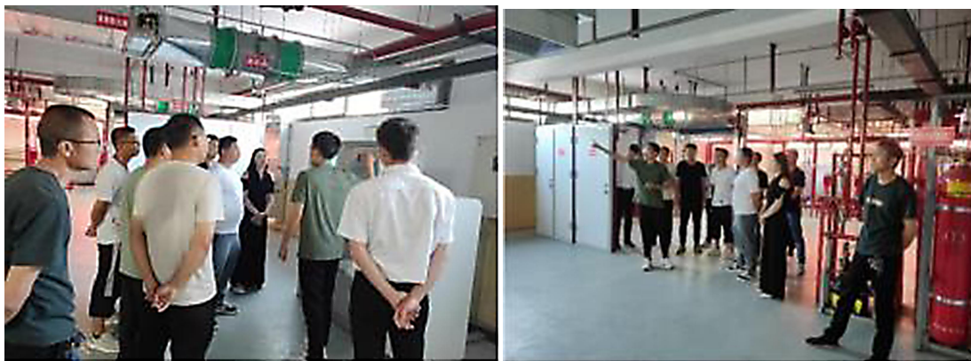
图 4-1 中级消防设施操作员消防实训基地现场培训
