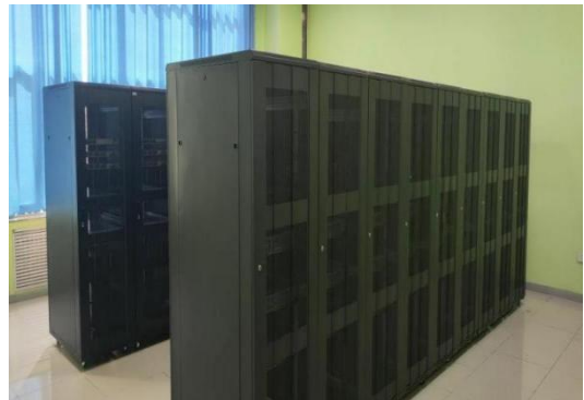
图 2-16 ICT 数据中心
