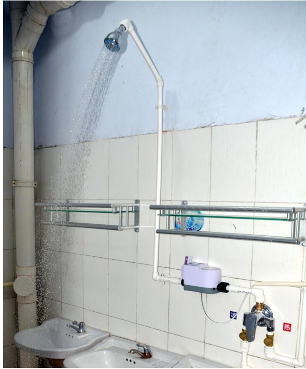
图 22 宿舍内服务设施----洗浴系统
