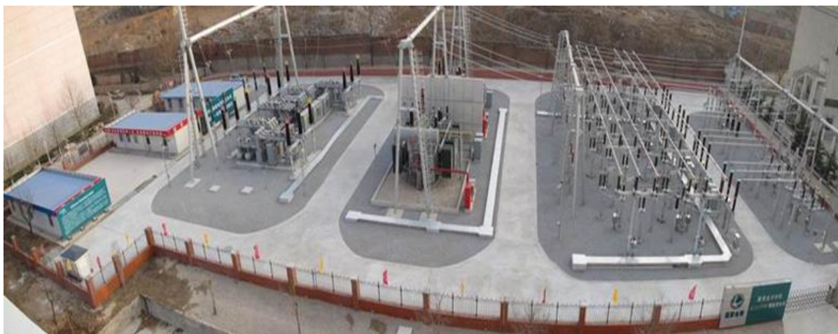
图 2-24 实训 220kV 智能变电站鸟瞰图
