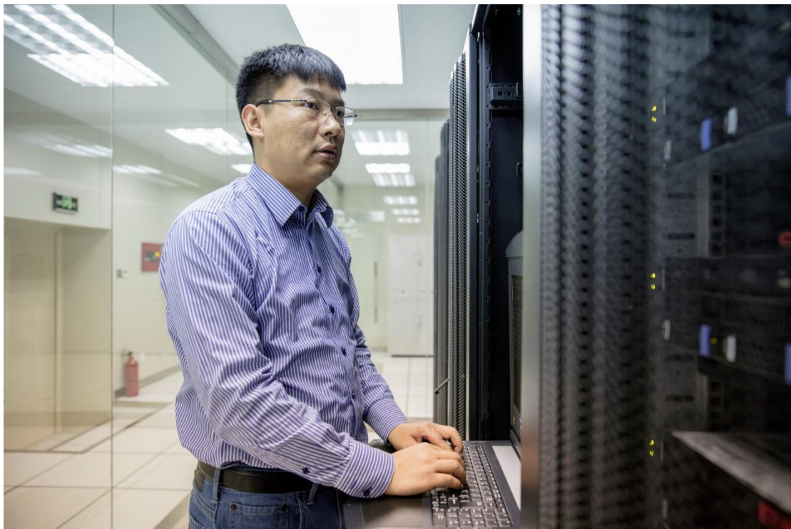
图 5-1 学校魏孔鹏教授在数据中心机房进行系统集成
