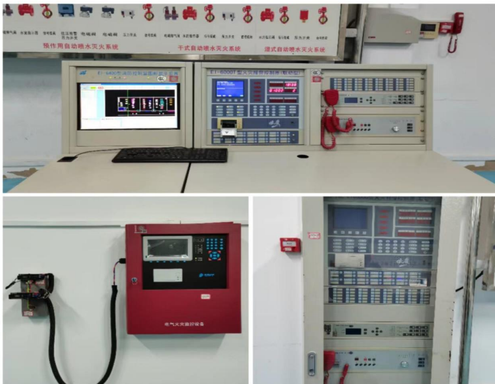
图 2-6 建筑消防技术专业学生演练“智慧消防”技术 数据来源：长沙南方职业学校建筑工程系
