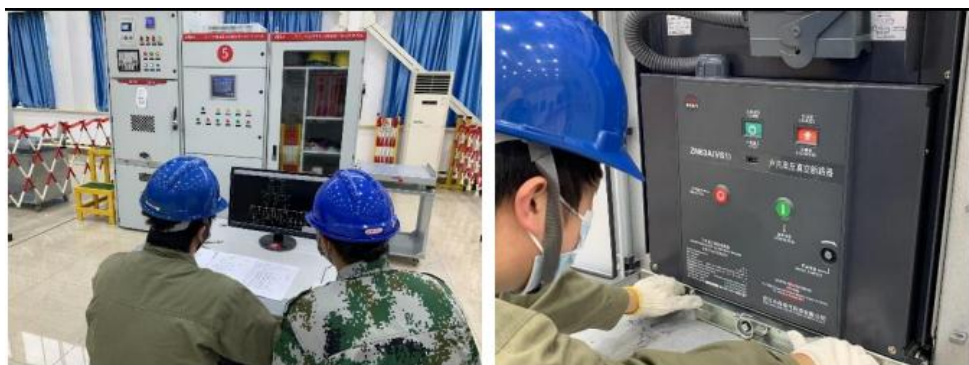
图 73 开展变配电运维检修全科医生培训实践
