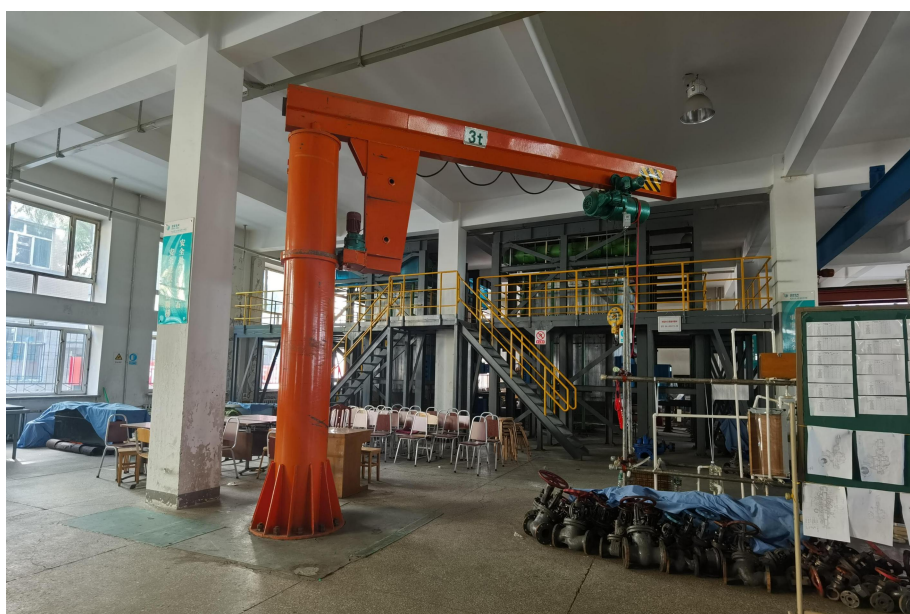
图 3-1 学院校内动力工程实训基地动装配实训区
