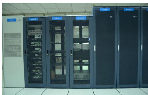
图 3 移动通信实训室
