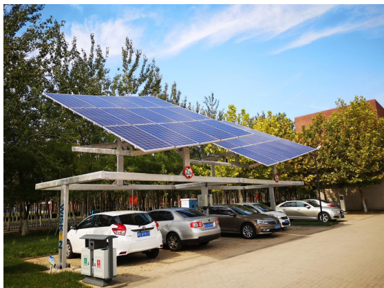
智能充电桩及追日光伏系统
