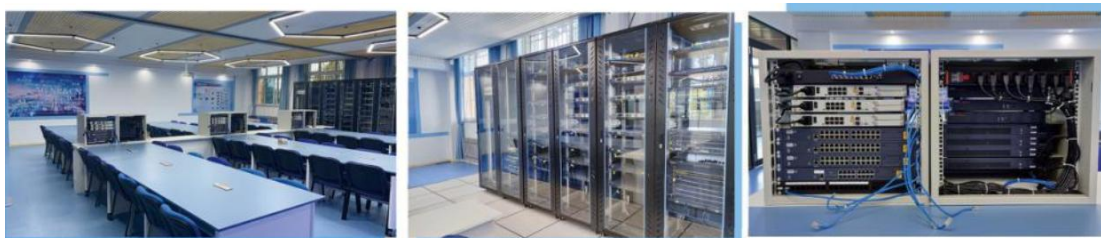
数据通信光实训室
