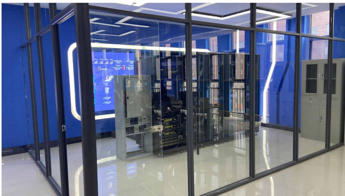
图 2 移动通信综合实训室实景图
