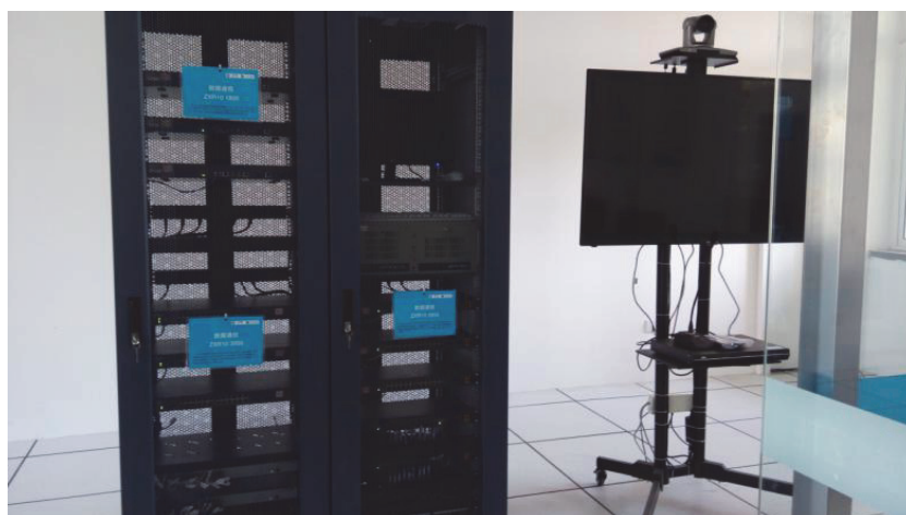
数据通信实训平台
